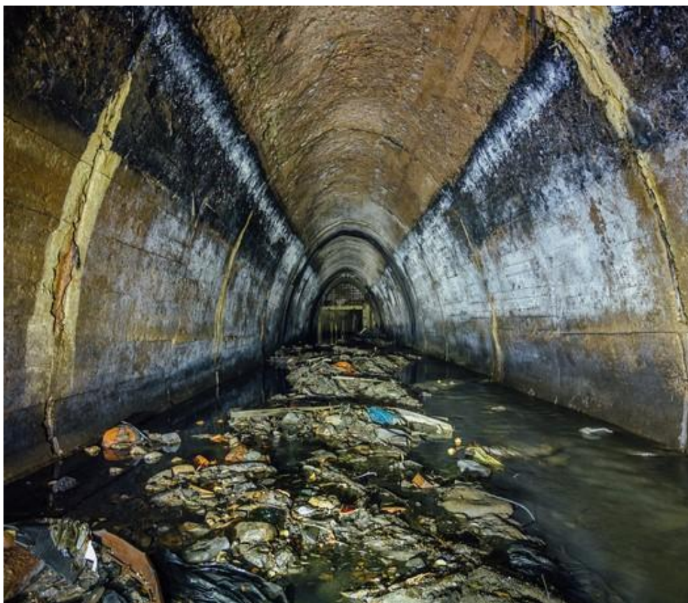
Slika 2. Kanalizacijske otpadne vode [4].
