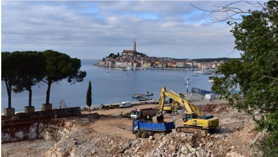
Slika 5. Uništavanje okoliša radi izgradnje marine [6].
