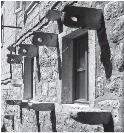
Slika 4. Probušene konzole u jednoj od kuća u ulici pod Minčetom
