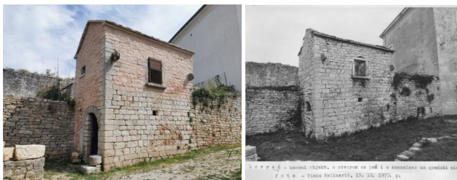
Slika 44. i 45. Sjeverno i zapadno pročelje Corpo della Guardia , snimila Irena Radoslav 2021. sjeverno i zapadno pročelje iste građevine prije adaptacije, autora V. Malinarić 1977. (Fototeka Konzervatorskog odjela u Rijeci)
