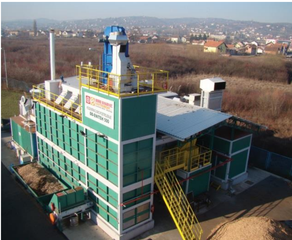
Slika 10. Kogeneracijsko postrojenje Đ.Đ. ENITEH 500 [27]
