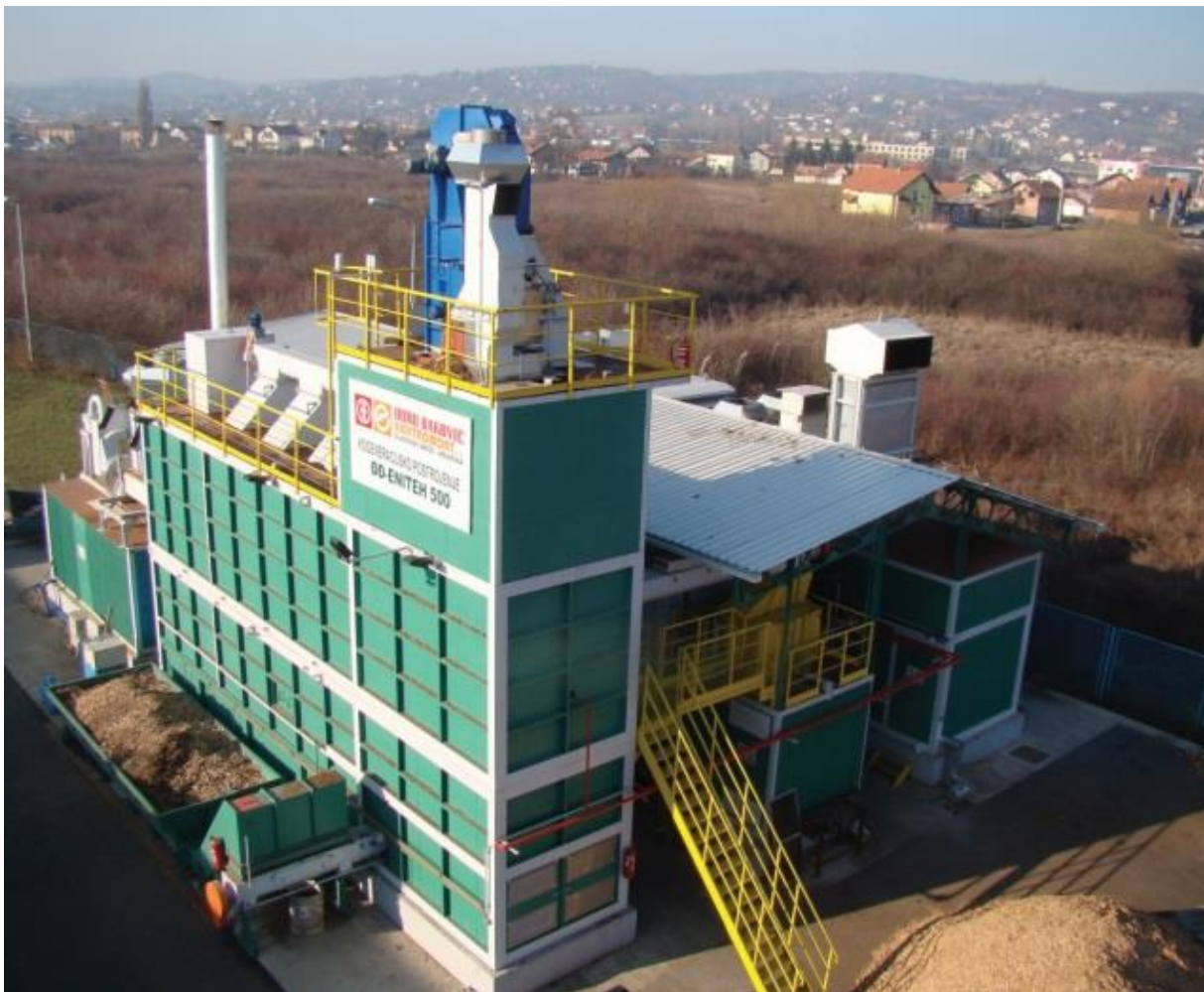
Slika 10. Kogeneracijsko postrojenje Đ.Đ. ENITEH 500 [27]
