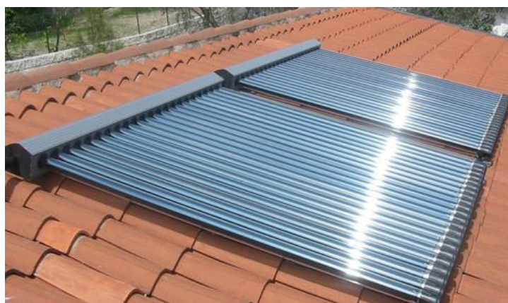
Sl.1.4. Solarni paneli na krovu kuće [4]
