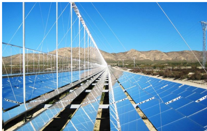
Sl. 3.18. Fresnelovi kolektori integrirani u sustav elektrane [26]
