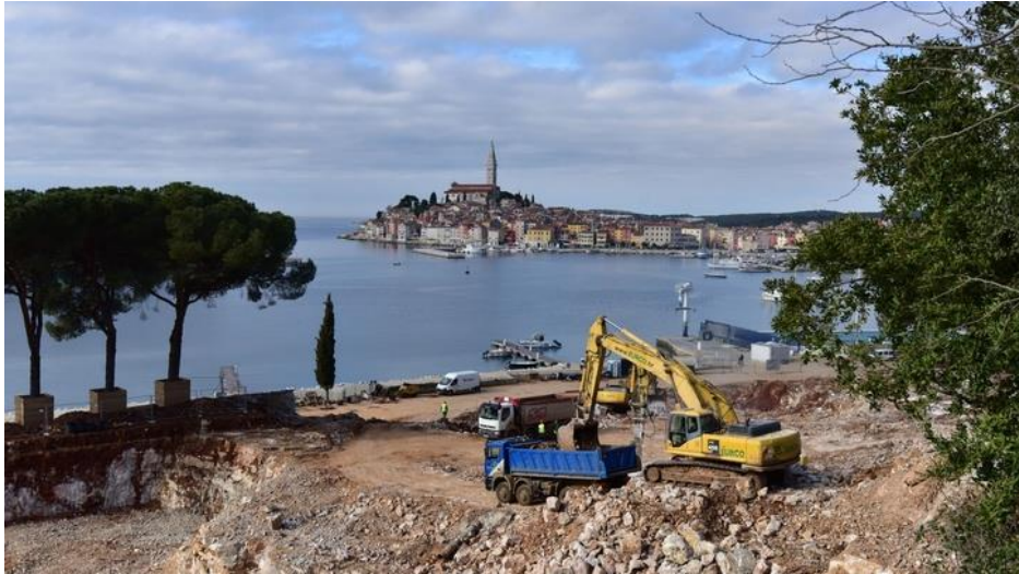
Slika 5. Uništavanje okoliša radi izgradnje marine [6].
