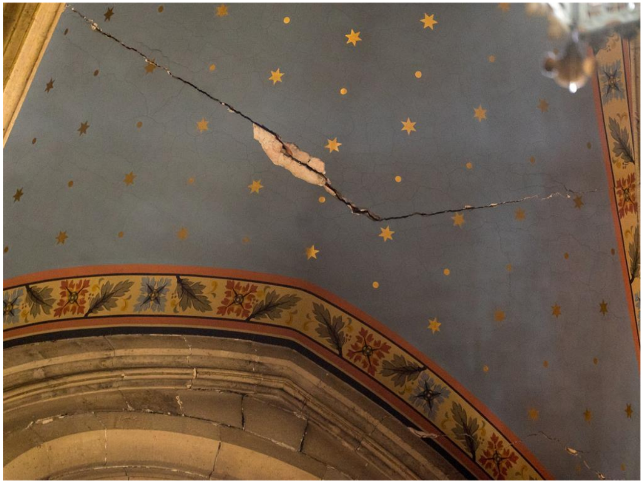
Slika 20: Prikaz oštećenja svoda
