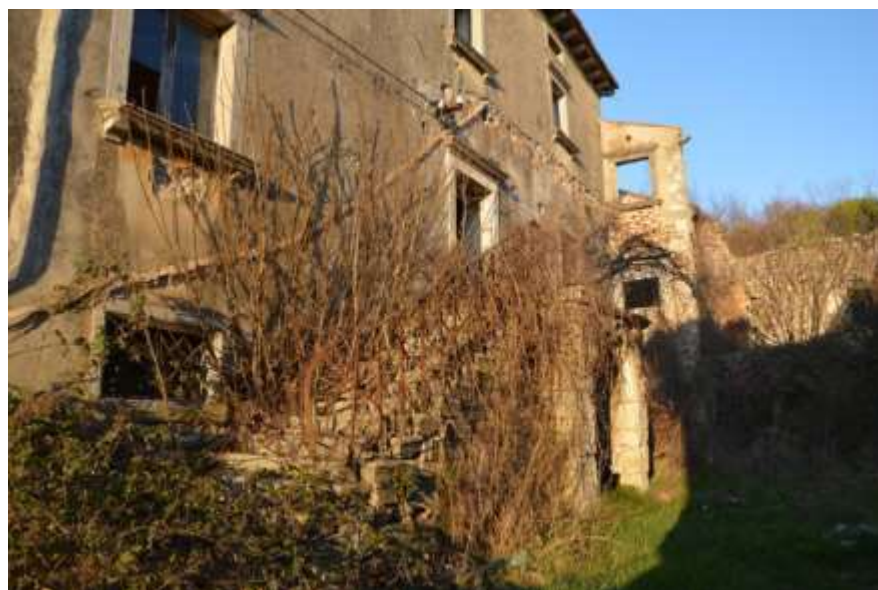
Slika 88. Dubrova, stambena zgrada kompleksa Franković-Vlačić, južno pročelje, stubište koje vodi u piano nobile (foto: K. Rabar, 2022.)
