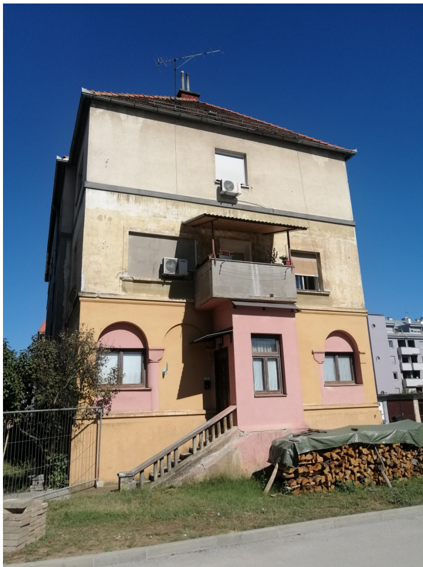
Slika 13. Događena stambena zgrada, južno pročelje, 2022.
