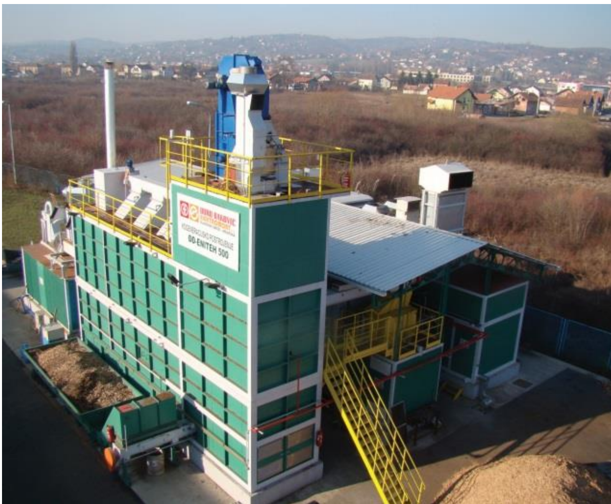
Slika 10. Kogeneracijsko postrojenje Đ.Đ. ENITEH 500 [27]
