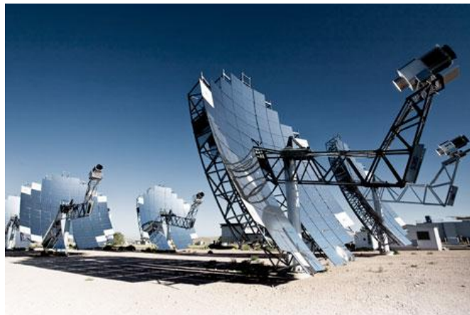
Sl.3.16. Primjer postrojenja parabolično tanjurastih kolektora [24]
