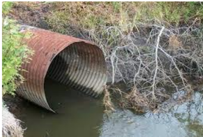
Slika 9. Izlijevanje komunalnih voda bez pročišćavanja [9].
