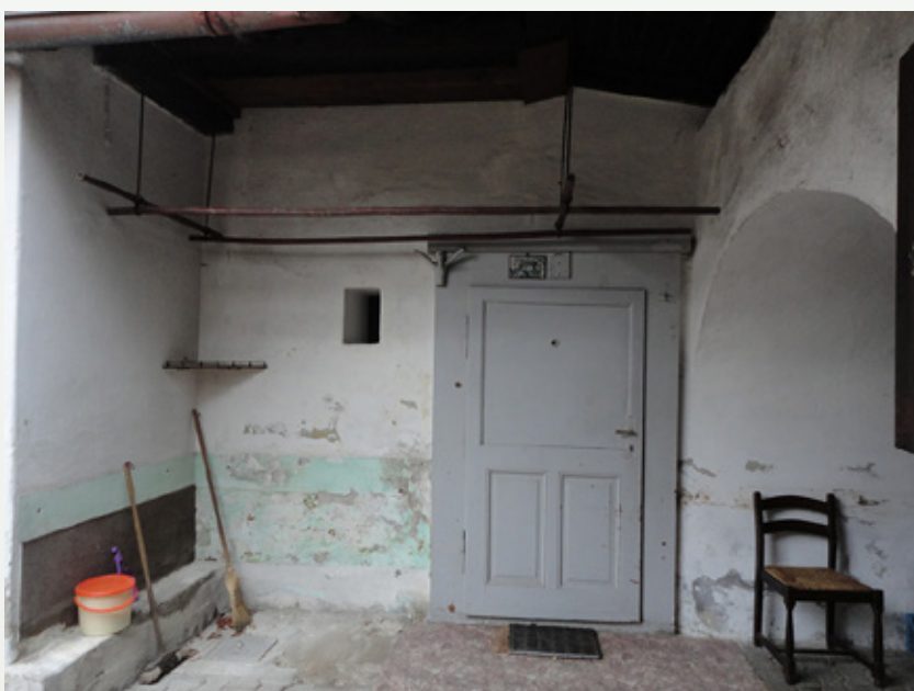
Plečnikova kuća, stanje prije obnove
