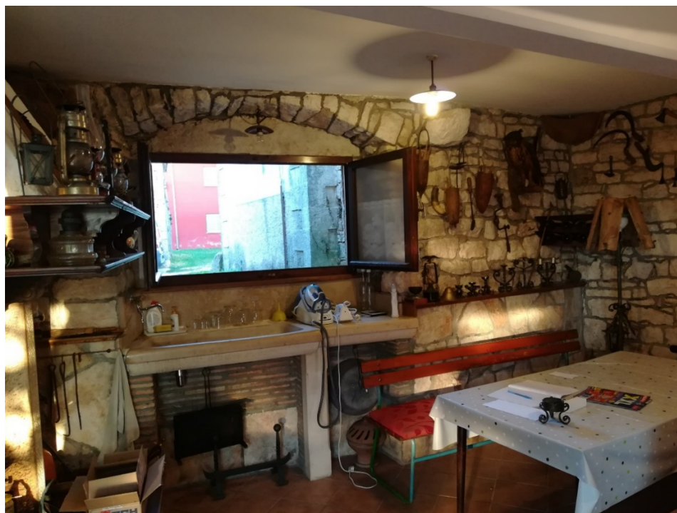
Sl. 20. Nekadašnji prolaz u sklopu zidina zaključen plitkim segmentnim lukom, prolaz je naknadno reduciran na veličinu prozorskog otvora
