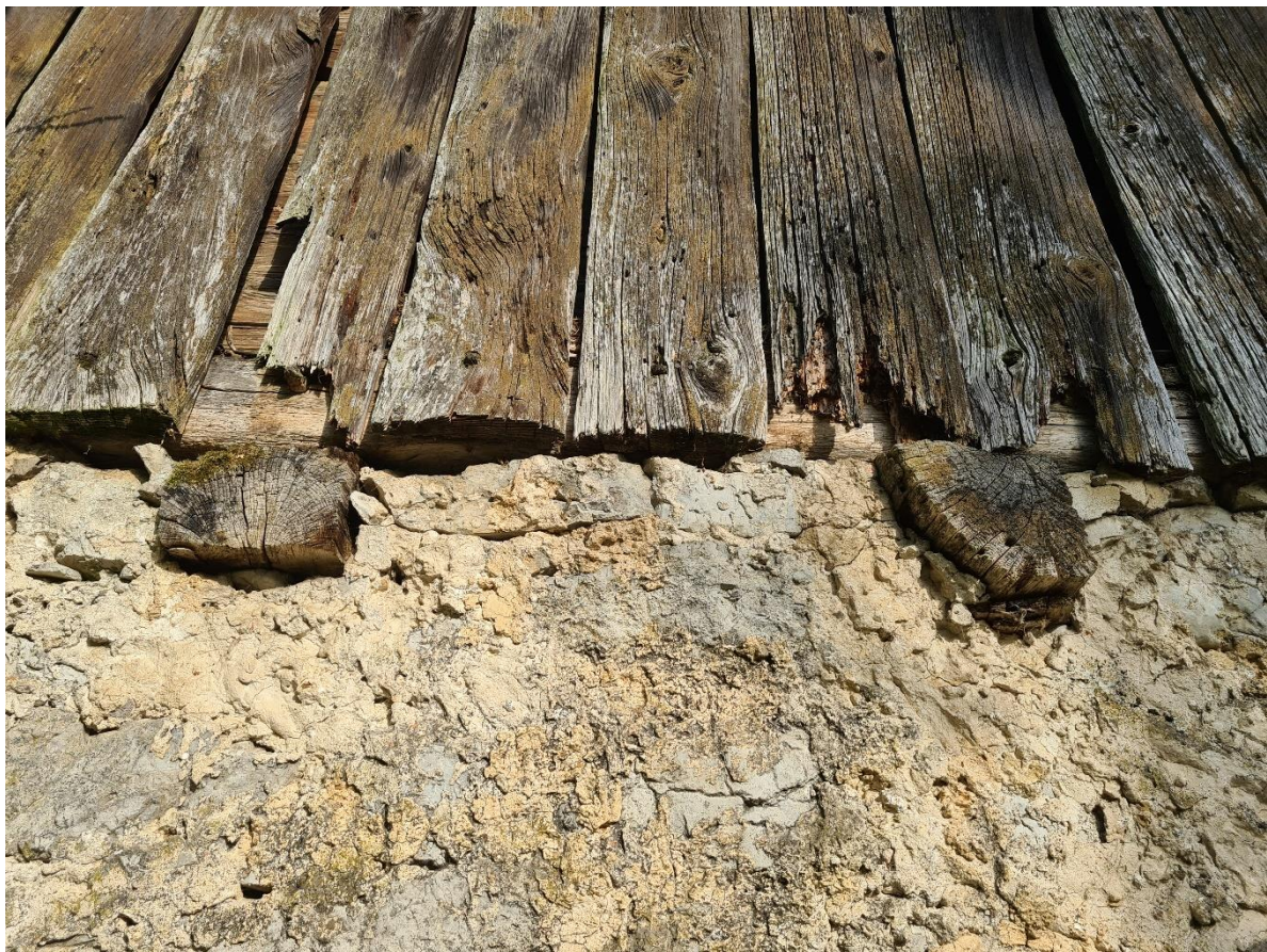
Slika 37. Spoj drvenog i kamenog materijala, stražnja strana šajara u Colnarima, detalj masivnih greda na kamenim temeljima (Foto: Katarina Tušek)
