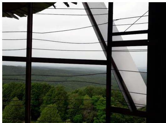
Slika 64. Metalna ploča u procesu otpadanja. Fotografija iz vlastite arhive (2023.).
