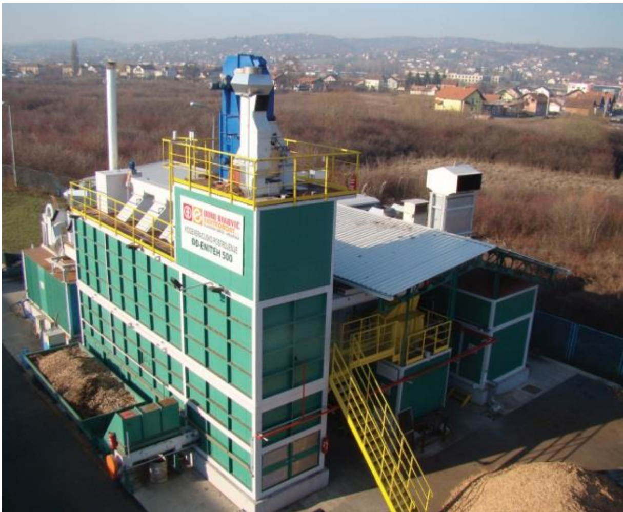
Slika 10. Kogeneracijsko postrojenje Đ.Đ. ENITEH 500 [27]
