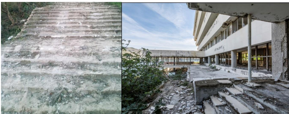
Slike 49. i 50. (lijevo) Stanje stepeništa koje vodi do morske obale i (desno) istočnog ulaza u hotel Pelegrin
