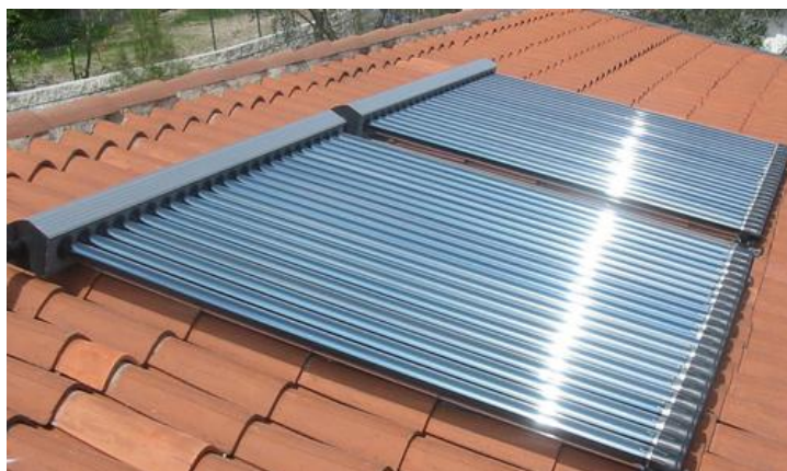
Sl.1.4. Solarni paneli na krovu kuće [4]
