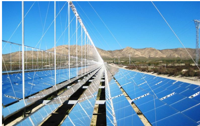
Sl. 3.18. Fresnelovi kolektori integrirani u sustav elektrane [26]
