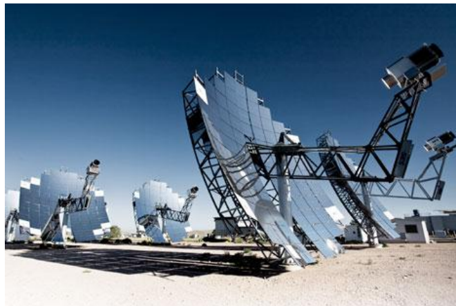
Sl.3.16. Primjer postrojenja parabolično tanjurastih kolektora [24]
