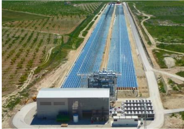
Sl.3.19. Solarna termoelektrana s Fresnelovim linearnim lećama Puerto Errado [27]
